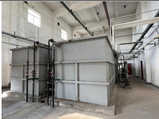
生活污水处理站
